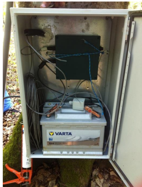
Photographie 7. Coffret installé au pied de l'arbre
